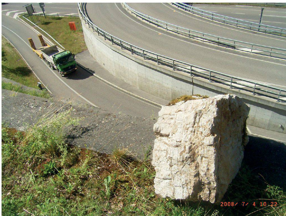
Figure 3.—Bloc arrêté dans la paroi ancrée. Block stopped in the wall anchored.
