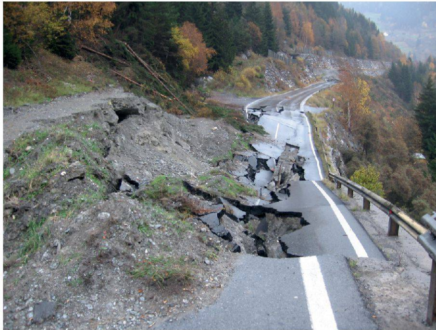
Figure 3.—Affaissement de la route de l’Arlberg proche de Strengen (Tyrol).
