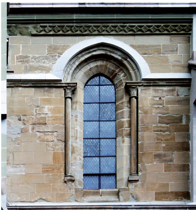
2 Cathédrale de Lausanne, nef, travée g, façade sud, état au 23 avril 2012. Exemple de parement affecté par des altérations en plaques traitées entre 2002 et 2007 (Photo CSC Sàrl).
