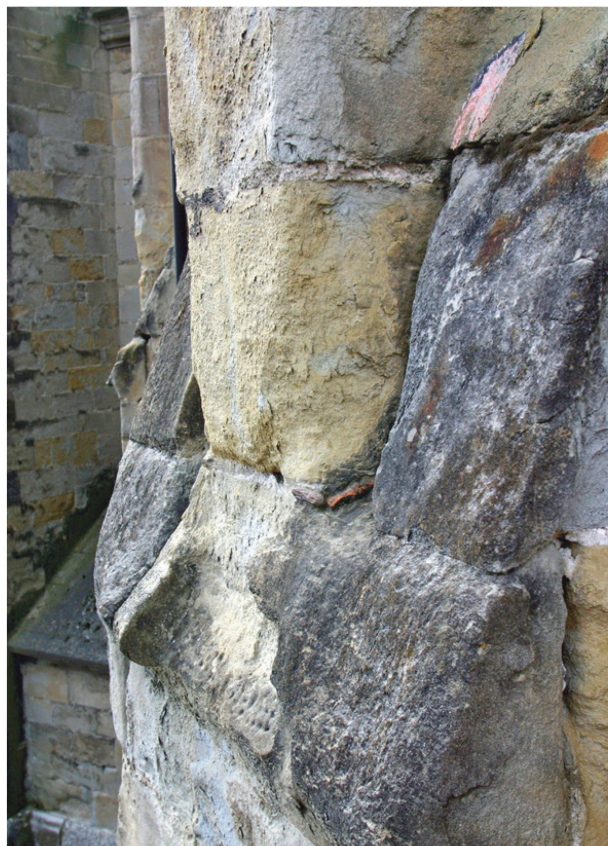
4 La pierre dégradée: contrefort du chœur de la cathédrale de Lausanne, XIII e -XVIII e siècles (Photo Bureau Christophe Amsler, Lausanne, 2006).
