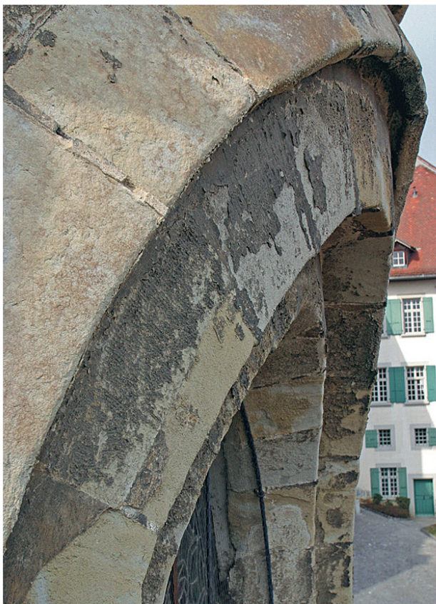
3 La pierre architecturée: baie axiale de l'abside du chœur de la cathédrale de Lausanne, XIII e -XVIII e siècles (Photo Bureau Christophe Amsler, Lausanne, 2006).
