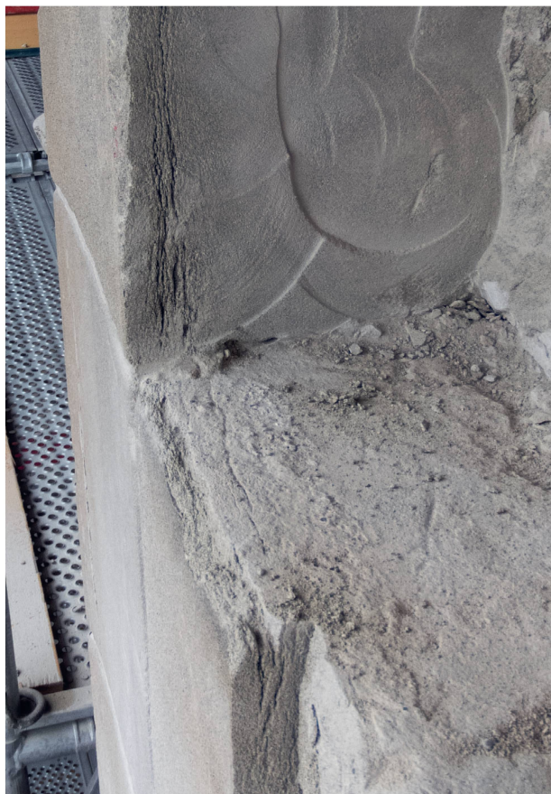
2 L'enlèvement d'un bloc destiné à être remplacé laisse apparaître, sur la tranche des blocs périphériques, une déstructuration de 2 à 3 cm formée sous les plaques.
