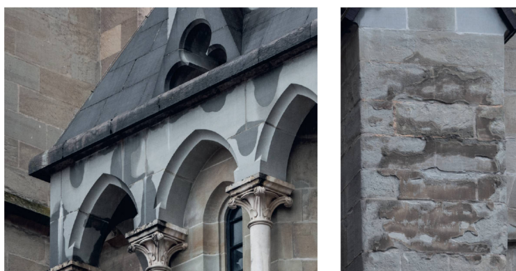
4 Photographies prises sous pluie. À gauche : mise en évidence d'infiltrations d'eau ressortant dans les joints de façade provenant probablement des joints du glacis de toiture. Observation en conditions de pluie verticale de faible intensité. À droite : les plaques déjà vulnérables semblent les plus exposées à la pluie. Observation réalisée en conditions de précipitation verticale de faible intensité.
