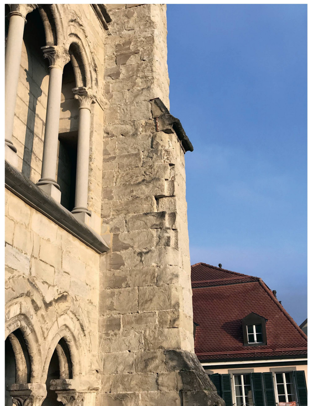
15 Tour du transept nord, retraite talutée avec dégradation angulaire du contrefort nord-ouest, Jean-Bernard Sinner (?) (photo Amsler Dom arch., 2021).
