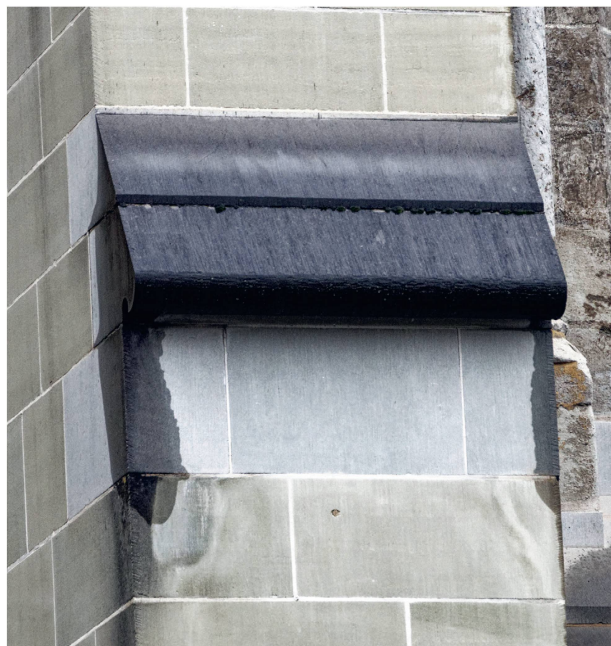
4 Retraite talutée d'un contrefort sous un régime de pluie installée. L'eau ruisselle sur le dos de la retraite, mais également sur les joues et les assises inférieures formant les bavures latérales, nommées fort à propos «moustaches» par Viollet-le-Duc (photo Rino Sàrl, 2019).
