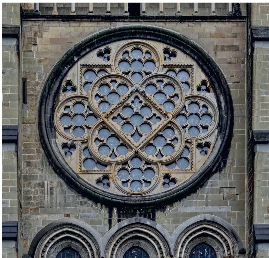
12 Rose de la cathédrale sous un régime de pluie installée. L'eau ruisselle sur les tores dans la partie supérieure et sur la façade sous la rose (photo Rino Sarà, 2019).
