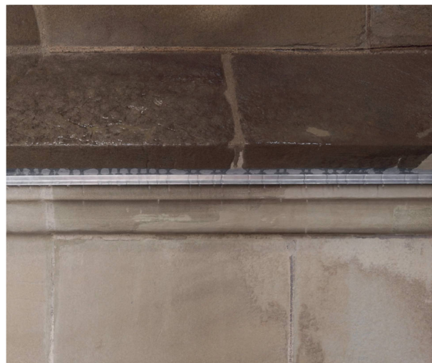
11 Mouchette de tôle dans le joint inférieur du cordon en fonctionnement lors d'essais in situ (photo Jeremy Bierer, 2021).
