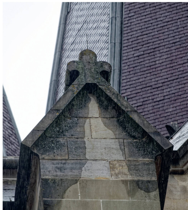
1 Chaperon d'un contrefort sous un régime de pluie installée. L'eau ruisselle librement sur le chaperon, la partie en saillie ainsi que sur les assises inférieures, théoriquement protégées par le débord du chaperon (photo Rino Sarà, 2019).
