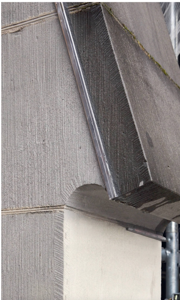
5 Coulisse rampante sur la joue de la retraite talutée en fonctionnement lors d'un essai in situ (photo Jeremy Bierer, 2021).
