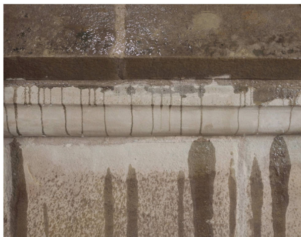
10 Photographie de l'humidification du larmier cordon des impostes des baies. L'eau, en l'absence de coupe-larme distinct, ruisselle librement sous l'élément de larmier et sur les parements inférieurs (photo Jeremy Bierer, 2021).
