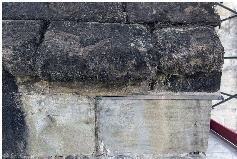
3 Le même élément après équipement d'une coulisse de ferblanterie (photo Claude Bornand, 2021).
