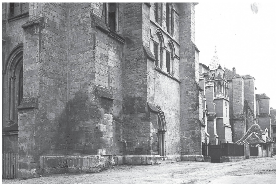
3 Retraites talutées des contreforts du transept nord présentant des états de dégradation divers (photographie anonyme, ACV, ACaL, vers 1900).
