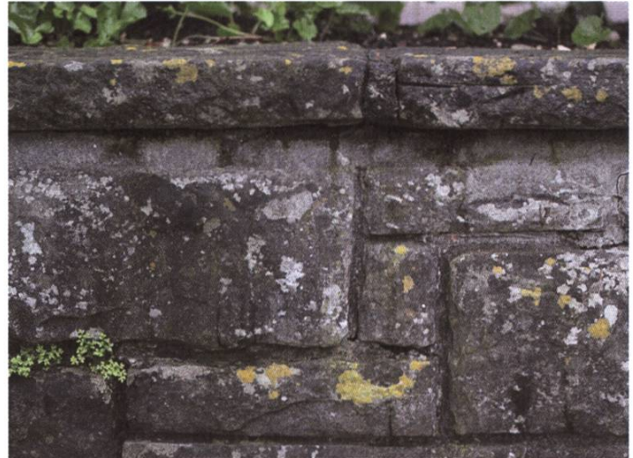
Stützmauer mit Krustenflechten, unter anderem der orange-farbenen Caloplaca velana
