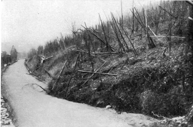
Abbildung 30. Rutschung vom November 1952 am nordwestlichen Rand des Rutschgebietes zwischen Neusetzstrasse und Schauenburgerstrasse. Überschiebung des Wulstes auf die Schauenburgerstrasse. Photo des Verf. 6. Dezember 1952
