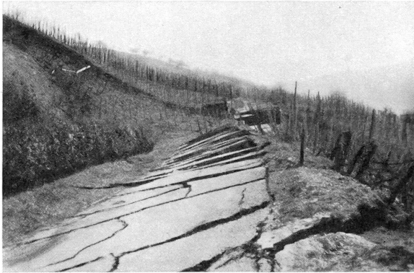
Abbildung 31. Abriss der unteren Teilrutschung. Bergwärts schiefgestellte Schollen der mittleren Teilrutschung an der Schauenburgerstrasse, östlich der Grube, vor Erreichen des Abrisses der unteren Teilrutschung.
