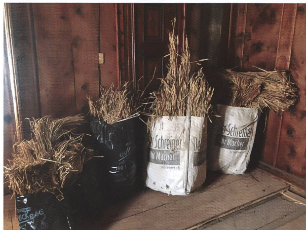
Abb. 1: Weizen- und Roggengarben aus der Casa Guberto in Soglio. Die Garben waren als Hausisolation verwendet worden und sind möglicherweise über 400 Jahre alt. Sie kamen 2020 bei Unterhaltsarbeiten zum Vorschein (Foto: Ruch & Partner Architekten AG, St. Moritz).
