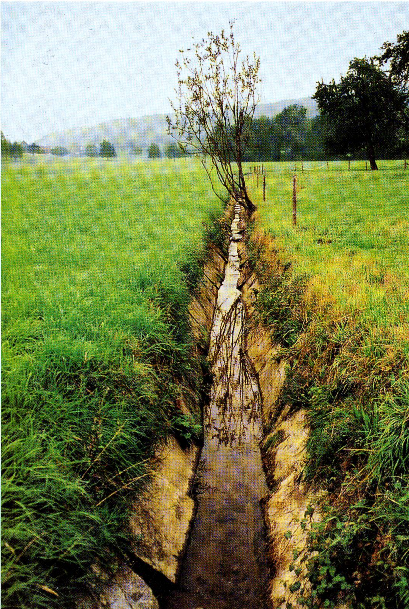
Abb. 3: Naturfremder Zustand der Grossen Aa beim Frohheim.
