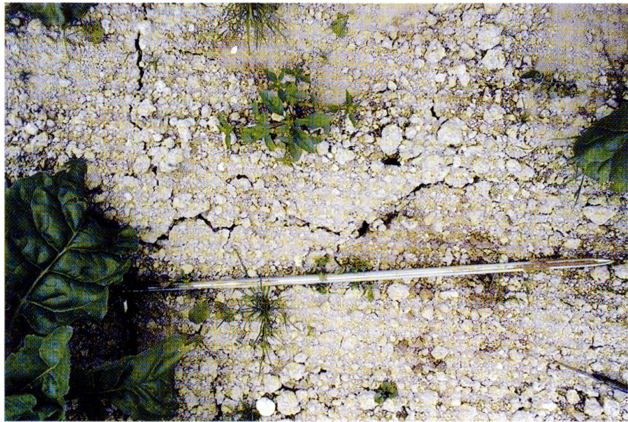
Abb. 5: Trockenheits-schäden durch Rissbildung auf Seekreide. Die organische Auflage ist nicht mehr präsent.
