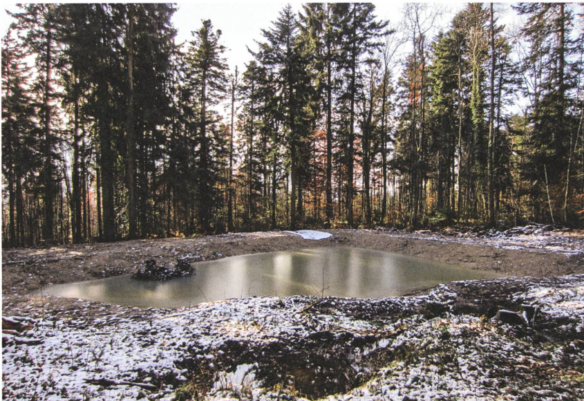
Abbildung 7: Waldweiher im Gebiet Süls in Selzach kurz nach dem Bau (19. November 2019), mitfinanziert von der Stiftung Albert Grütter-Schlatter zur Ergänzung des solothurnischen Naturschutzfonds. Bild: Mélila Saucy
