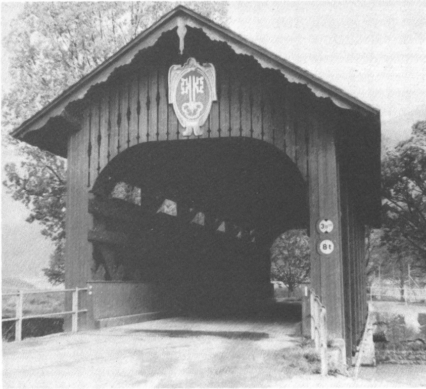
14. In Buochs kann die Fadenbrücke , die im Unterbau ein neues Holzwerk und eine Totalrenovation erhielt, wieder dem Verkehr übergeben werden. Das Anbringen des Nidwaldner Wappens war sozusagen der i-Punkt und Abschluss der Arbeiten.
