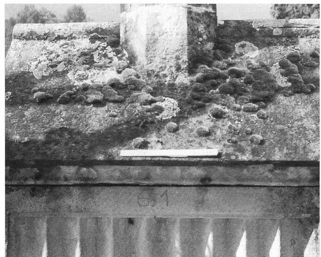
Stans, Winkelrieddenkmal. Schadensbefund: Verschmutzung und biologischer Bewuchs.
