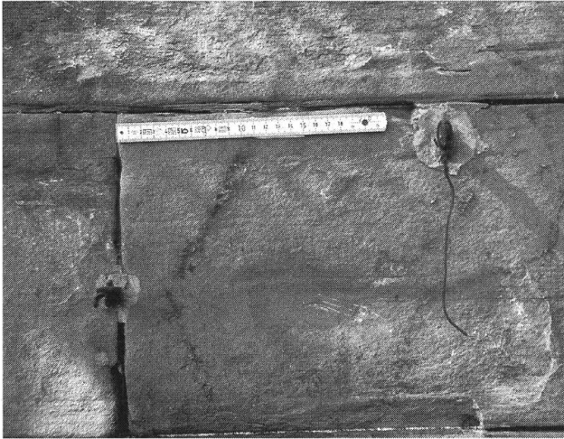
Stans, Winkelrieddenkmal. Schadensbefund: Offene Fugen verursacht durch Efeubewuchs.
