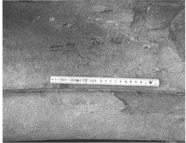
Stans, Winkelrieddenkmal. Schadensbefund: Abranden des Sandsteins verursacht durch Umwelteinflüssen.
