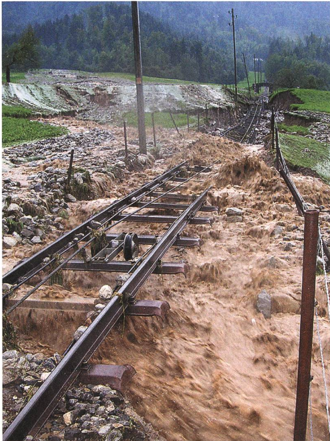
Die Geleise der Stanserhornbahn wurden vom reissenden Kniribach auf einer beträchtlichen Länge unterspült.
