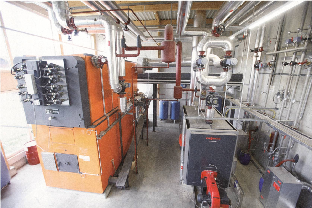
Das Zentrum des Wärmeverbundes mit dem Waldholzschnitzelofen (links) und der Verteilanlage. des Wärmeverbundes.
