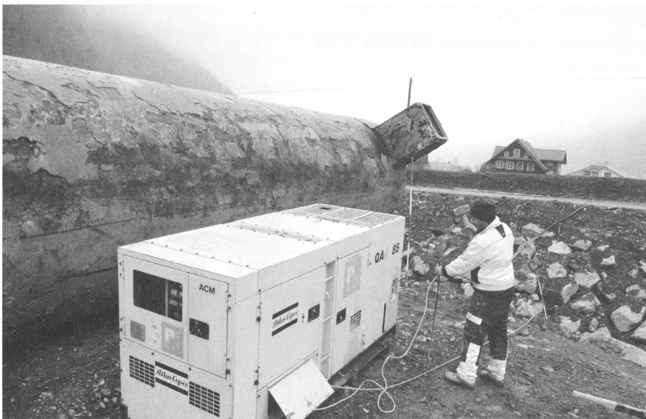
23.12. Die ausgebuddelten Tanks dienten dem Bund während des Krieges als Pflichtlager für Flugbenzin und Dieselöl.
