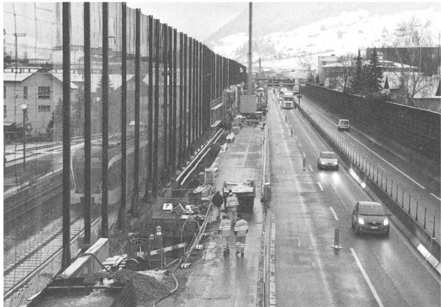
8.1. Lärmschutzgalerie Stansstad: Sorgen und Gefahren.
