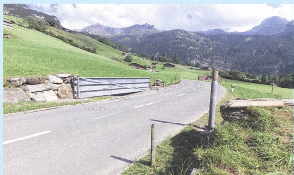
C: Wird das Tor geöffnet, fließen die Wildbäche über die Strasse Richtung Secklisbach.
