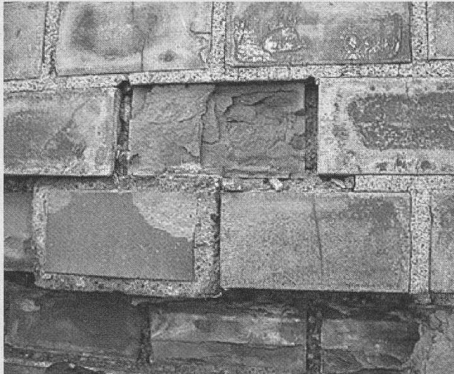
Abplatzen der hydrophoben Schicht.
