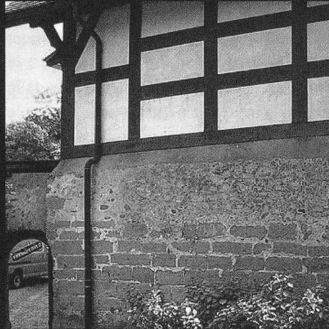
Couvent de la Maigrauge à Fribourg, mur extérieur. Le mur est composé de différents matériaux et techniques.
