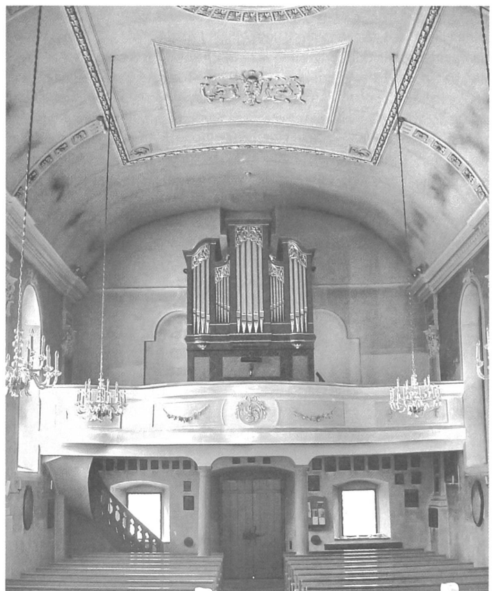
Abbildung 1: Innenansicht einer Kirche mit Verschwärzungen nur fünf Jahre nach der letzten und kurz vor der erneuten Innenreinigung.
