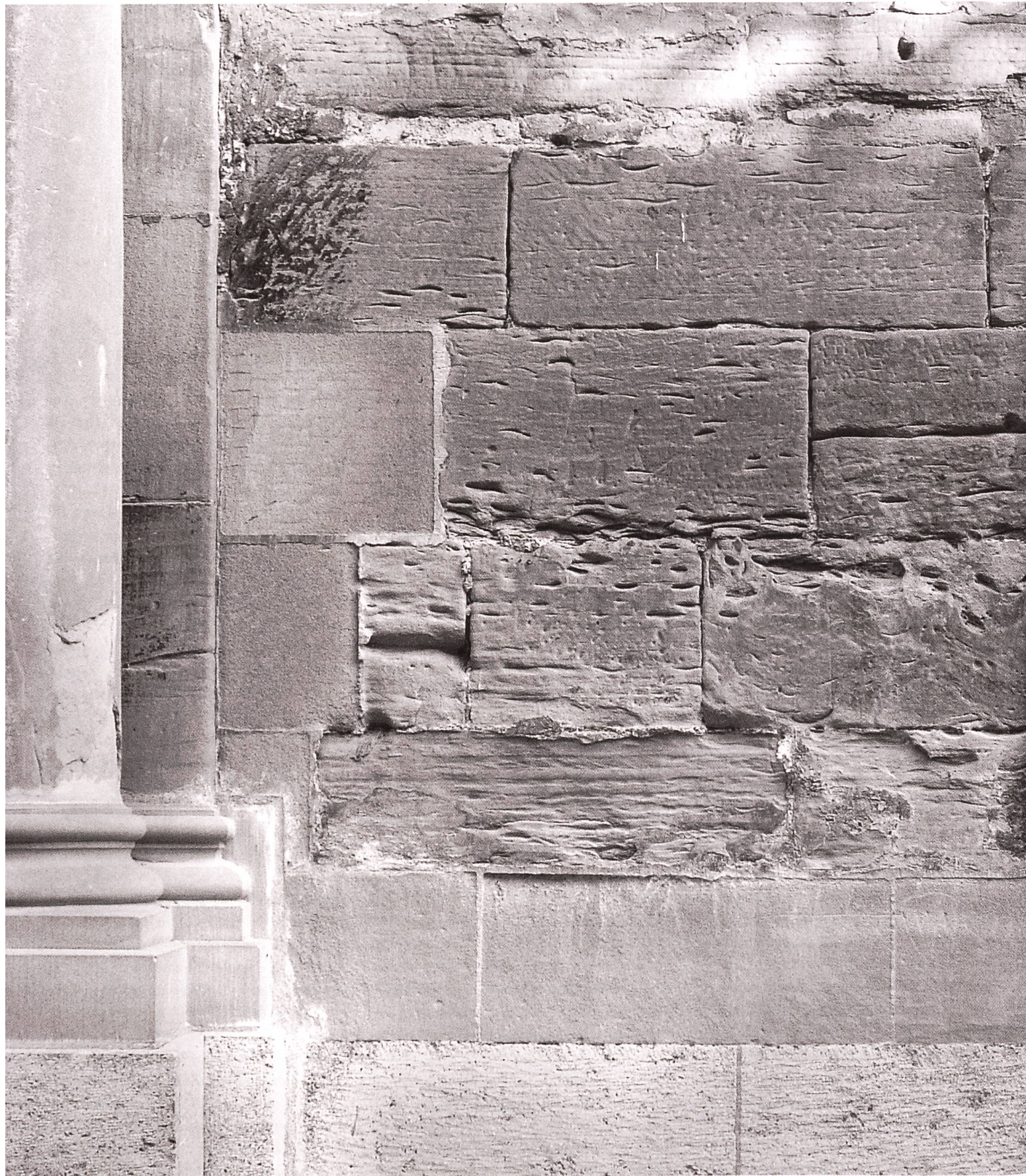
Fribourg, église de St-Maurice, entrée latérale; éléments d'origine dégradés, pièces de remplacement (socle, première assise) insérées au XX e siècle.
