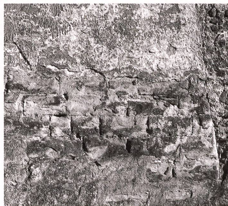
Fribourg, chœur de l'église de St-Maurice, XIV e siècle; parement partiellement couvert d'un enduit de date incertaine. Quel état final faut-il envisager?
