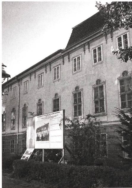
Das «Schoeler-Schlösschen» in Berlin: Gut zu erkennen ist der fehlende Teil des Daches.
