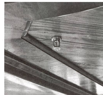
Die in die Holzdecke harmonisch integrierte Sprinkleranlage.
