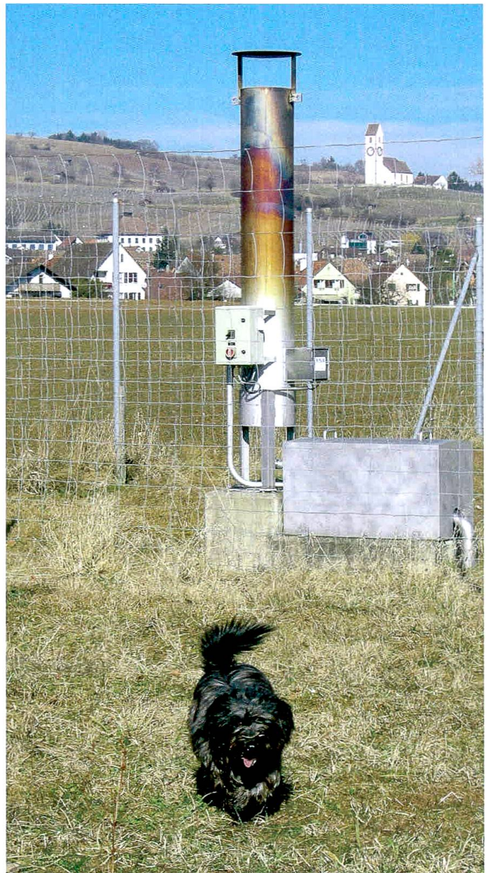
95 ARA Hallau, Gasfackel. Foto: ALU
