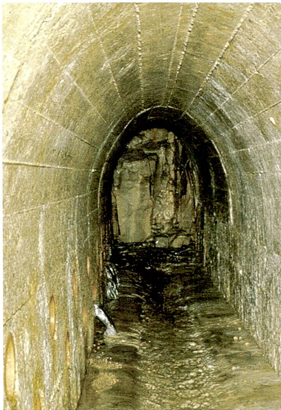
53 Horizontalschacht mit Quelleinlauf links, Holdertobelquelle, Beringen. Foto: ALU
