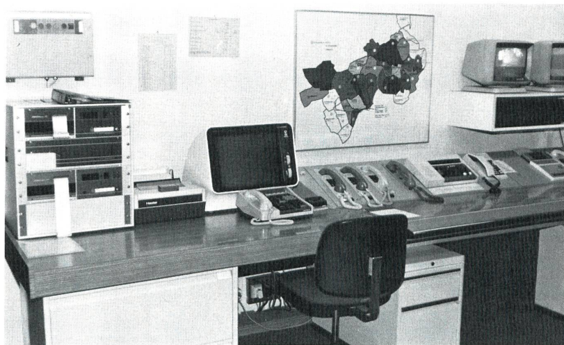
Alarmzentrale bei der Stadtpolizei mit Aufzeichnungsgerät, Bildschirm, Telefon-, Funk- und SMT-Anlage.
