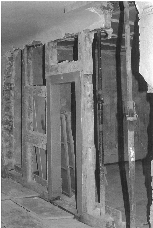
4 L'installation de poêles et de canaux de fumée a endommagé la structure des colombages
