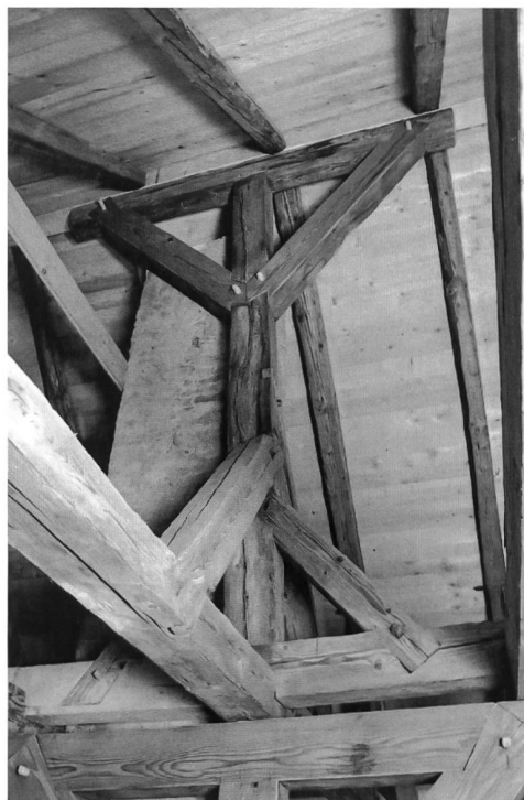
Fig. 6 Suite à la déformation de la charpente, une partie de la panne faitière d'origine a été remplacée et soutenue par un poteau. Ce dispositif de renforcement a été conservé et la panne faitière doublée.
