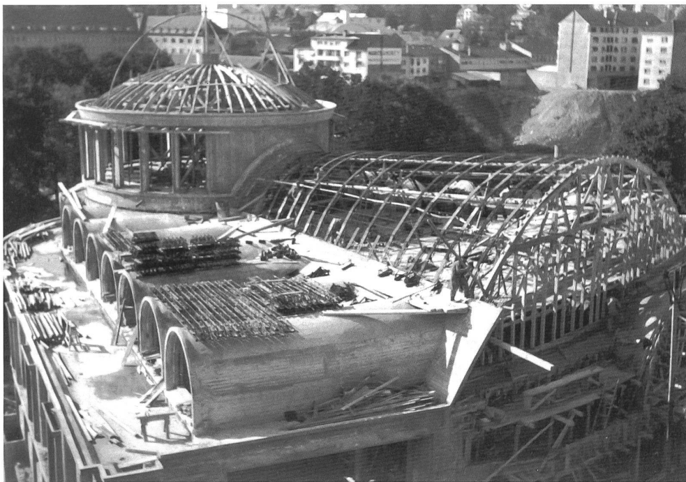
Fig. 39 Mise en place des cintres métalliques de la grande voûte, octobre 1952. – Sur les cintres de la coupole initialement prévue, on voit le gabarit de la nouvelle coupole hémisphérique. Le chevet ayant été imaginé au milieu d'un jardin à la française limité par des immeubles, Honegger l'avait conçu en conséquence. Antognini estimait qu'il fallait surélever la coupole – posée sur un tambour et non sur des claustras comme le proposait l'avant-projet –, pour qu'elle fût visible du boulevard, d'autant plus qu'on reprochait volontiers à l'église son peu d'élévation. Honegger n'insista pas et choisit l'une des propositions élaborées par l'architecte fribourgeois. La solution retenue n'est pas satisfaisante, la coupole étant quoiqu'il en soit toujours trop basse pour se détacher de l'église.
