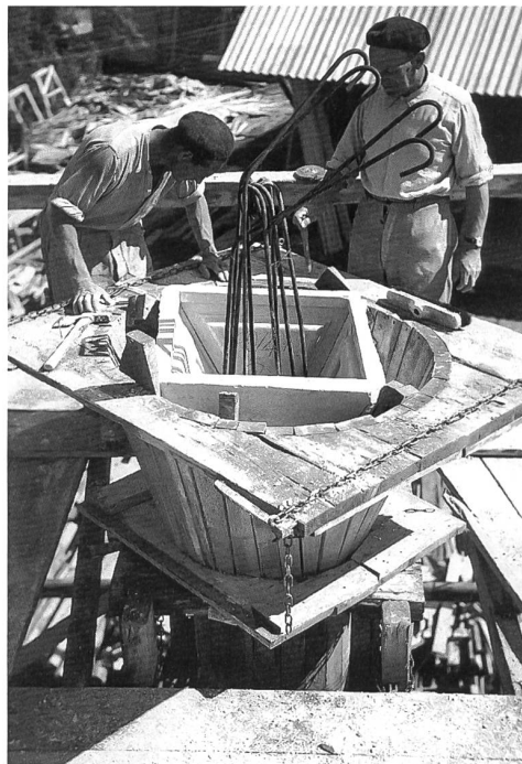
Abb. 52 Arbeiter beim Setzen der Gussform für die Kapitelle des Schiffs von Antoine Claraz, Frühling 1952.
