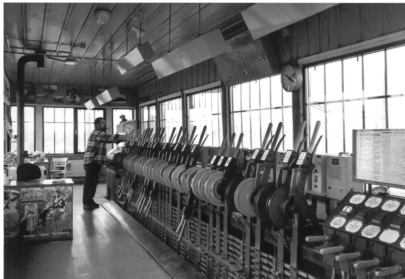
Abb. 5 Der Stellwerkwärter stellt entsprechend der angeforderten Fahrstrasse (ganz rechts und Abb. 3) die Weichen- und Signalhebel. Im untern Teil der Hebelbank die waagrechten Verschlusslineale und die mit den einzelnen Hebeln verbundenen senkrechten Verschlusschieber.
