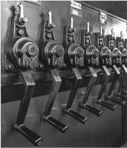
Abb. 2 Das Befehlswerk von 1896. Mit den Kurbeln fordert der Fahrdienstleiter für jeden ein- und ausfahrenden Zug eine Fahrstrasse an. Der Verschlussapparat im Innern des Gehäuses sperrt «feindliche» Fahrstrassen.
