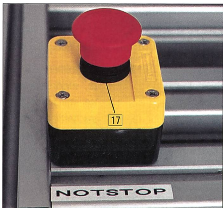
Abb. 11: Der Notstopp [17] wird im Falle eines technischen Defektes vom Untersucher manuell betätigt. Der Stromkreis wird unterbrochen und die SLR-Maschine steht unmittelbar still. Der Proband wird sofort aus seiner fixierten Position befreit.
