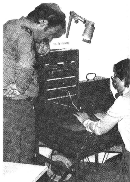
La centrale Tf in buone mane.
