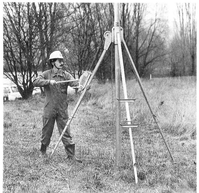
Statif avec élévateur de tube du mât d'antenne A-362.
