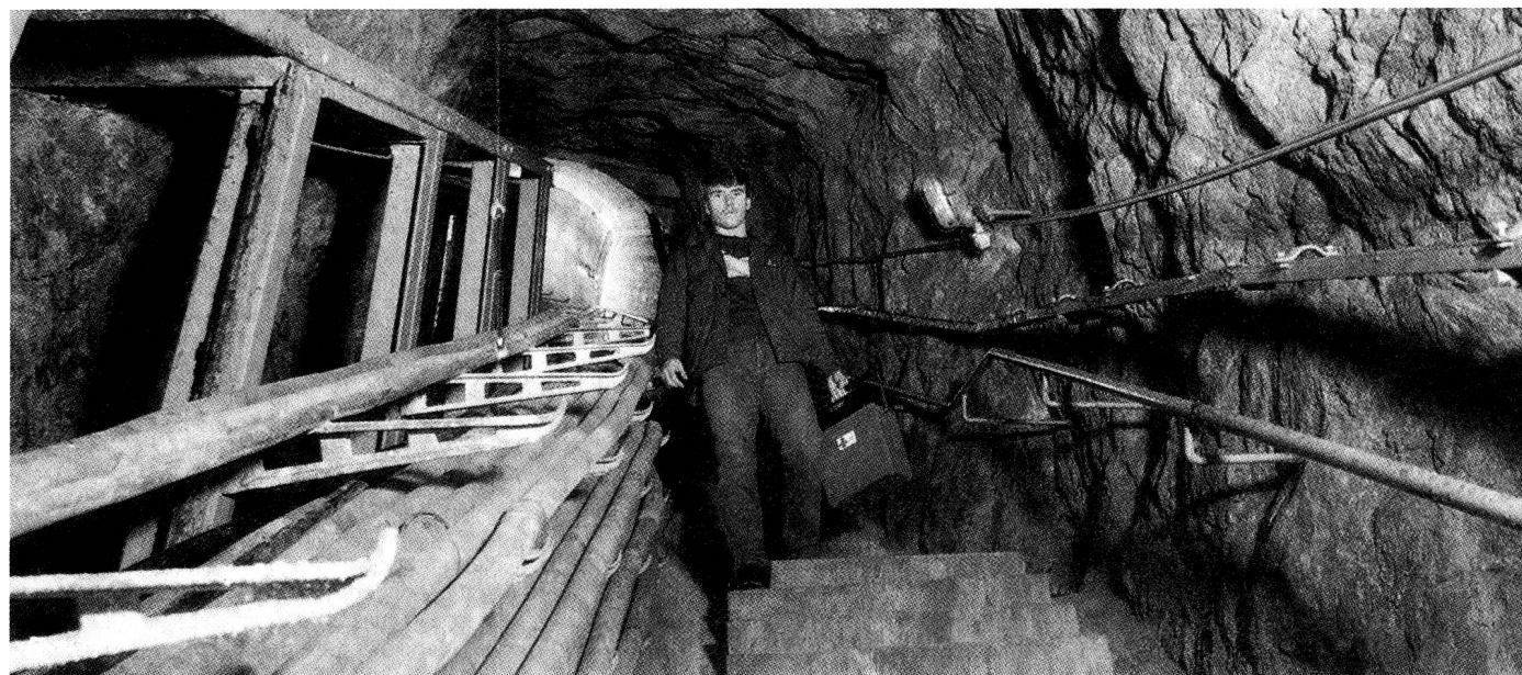
Unterirdische Kabelkanäle ausschliesslich für Fernmeldekabel im Zentrum von Helsinki.
