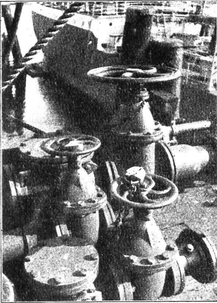
Der Mechanismus der Rohrleitung, die vom Transportschiff in die Erdölbehälter an Land führt. 9000 Tonnen Rohöl können in 24 Stunden aus dem Schiff hinüber gepumpt werden.
