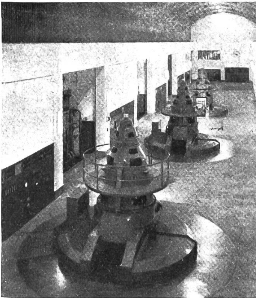
Unterirdische Maschinenhalle des Kraftwerks Innertkirchen. Das Wasser des Stausees auf der Grimsel erzeugt in der Zentrale Handeck Elektrizität. Das in den letzten Jahren neu errichtete Kraftwerk Innertkirchen nützt das gleiche Wasser 650 m tiefer nochmals aus.
