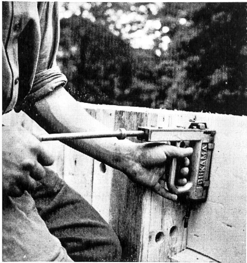
Abb. 1. Befestigen einer PVC-Schaumstoffplatte mit Hilfe eines Rohrhefters und Heftklammern an der Schalung aussen
