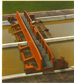
Hydraulische Räumler ARA Aadorf
