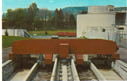
Hydraulische Räumler ARA Aadorf
