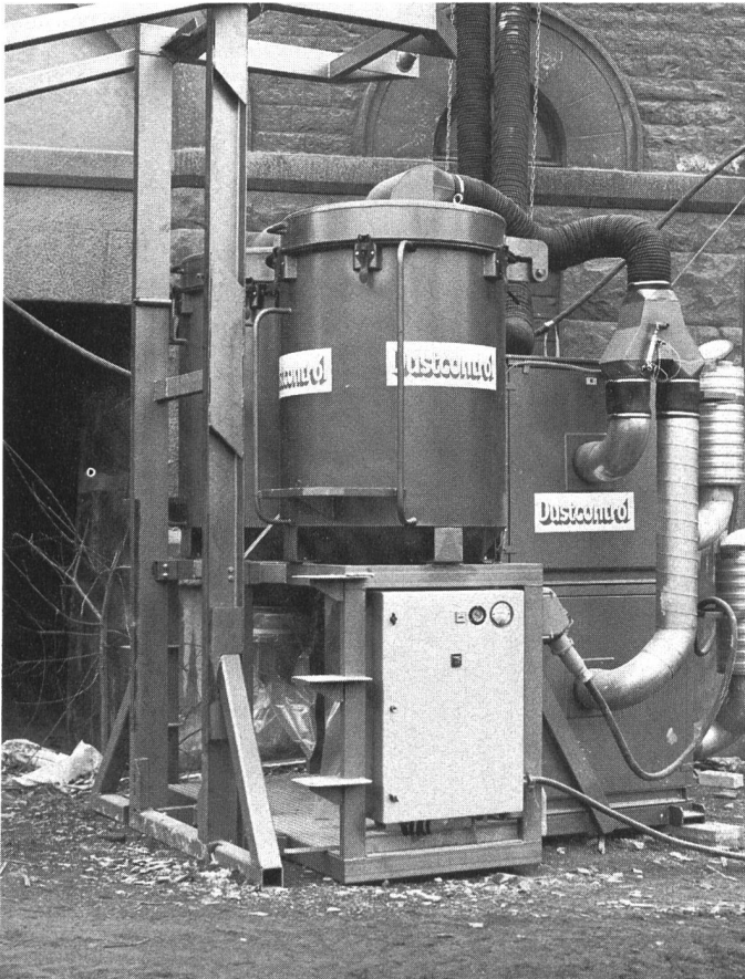
Staubabscheider DC Ventilation mobil, 37 kW, als Entlüftungsaggregat. Dieses Aggregat besteht aus zwei parallelgeschalteten Zyklonen vom gleichen Typ wie beim Hochdruckaggregat. Als Saugaggregat dienen zwei zweistufige Ventilatoren zu je 18,5 kW. Die gesamte Luftfördermenge beträgt ca. 10000 m 3 /Stunde.
