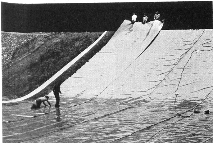
Auslegen der 4,20 m breiten und 51,50 m langen KDB aus Hochdruck-Polyäthylen (Sarnafil FP) grün durchgefärbt auf die vorbereiteten Flächen des Bodens und der Böschung in der zukünftigen gesicherten Deponie. (Foto: Ciba-Geigy AG, Monthey).
