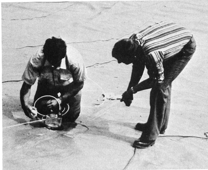
Die mit dem Heizkeil-Schweissapparat erzeugten Doppelnähte werden mit einem Luftdruck von 2 bar geprüft. Sinkt der Druck nach 15 Min. um nicht mehr als 0,1 bar ab, so ist die Prüfung bestanden. Fehlstellen, die sehr rasch aufgefunden werden können, werden ebenfalls mit KDB nachträglich mit Hilfe eines Handextruders saniert. Diese Schweissnähte werden mit der Vakuumhaube geprüft. Undichtigkeiten zeigen sich durch Blasenbildung im aufgespritzten Lecksuchspray an. (Foto: Sarna Kunststoff AG in Sarnen).
