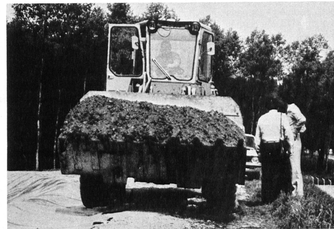
Praktische Demonstration der Flächendruckfestigkeit und hohen Durchstossfestigkeit der 2 mm starken KDB Sarnafil FP. Der Pneulader fährt ohne weiteres über die auf Kiesboden lose verlegte KDB hinweg, ohne dass diese irgendwie beschädigt wird. (Foto: Sarna Kunststoff AG, Sarnen).
