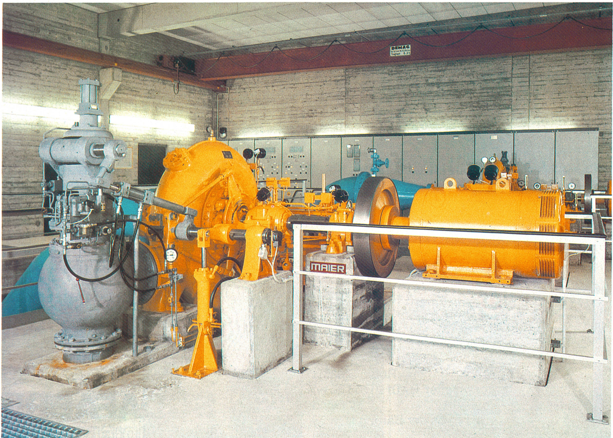
Abb. 3. Zwei Turbinenanlagen sind im Hochbehälter Lewerberg installiert. Abbildung 3 zeigt die Anlage I mit einer Generatorleistung von 400 kW. Links im Bild ist der hydraulisch arbeitende Druckregler erkennbar, der bei dem durch eine Schnellabschaltung der Turbine entstehenden Druckstoss eine Umgehung öffnet und so Schäden verhindert.
