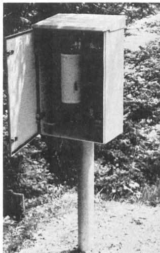
Abb. 4. Elektrische Niveaumessung und Registrierung mit Drucksonde in 160 m Tiefe, Messbereich 20 mWS.
