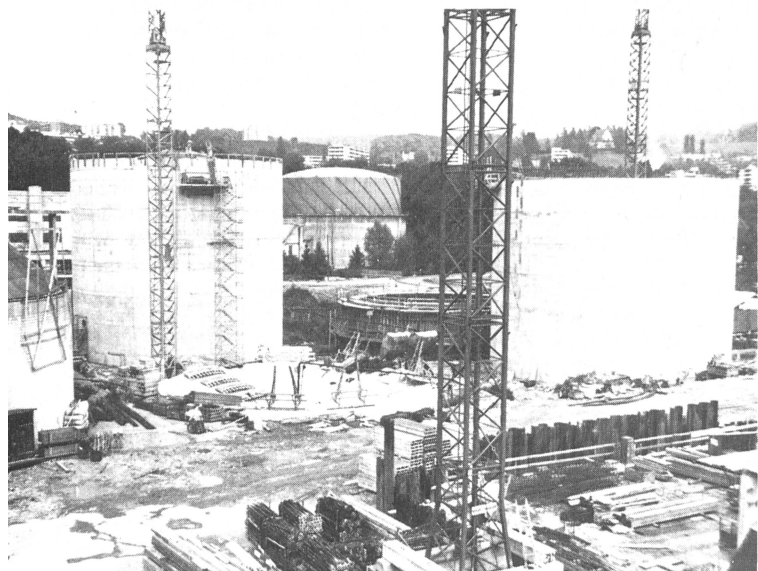
Abb. 8. Die vier neuen Behälter der Vorfaulanlage im Bau. Am rechten Bildrand ist ein Behälter der bestehenden Faulanlage sichtbar.
