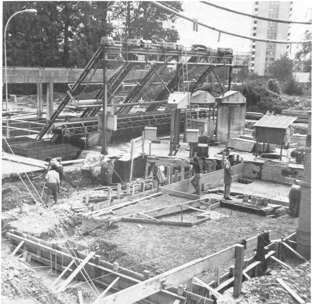
Abb. 2. Die Rechenanlage, welche im Zuge der Kläranlageerweiterung zur Vermeidung von Geruchsemissionen von einem Gebäude umschlossen wird.
