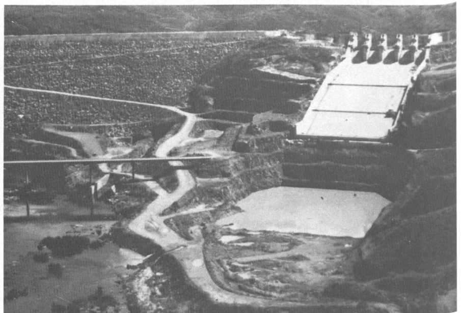
Die Mehrzweckanlage Pedra do Cavallo dient in erster Linie der Trinkwasserversorgung der Stadt Salvador do Bahia in Brasilien. Links der fast vollendete 140 m hohe Steindamm und rechts die Hochwasserentlastung mit den deutlich erkennbaren Belüftungsabsätzen zur Verhinderung von Schäden durch Kavitationserosion.
