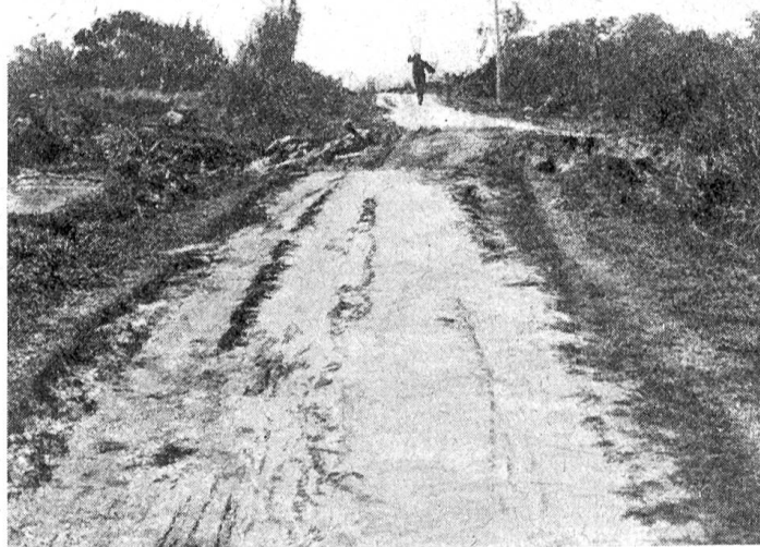
Aufgerissene Straße auf Formosa
